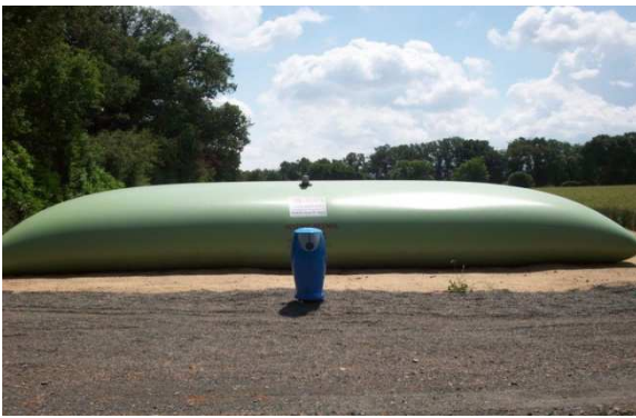
Réserve d'eau souple de 120 m 3 utilisable par le biais d'un poteau d'aspiration
