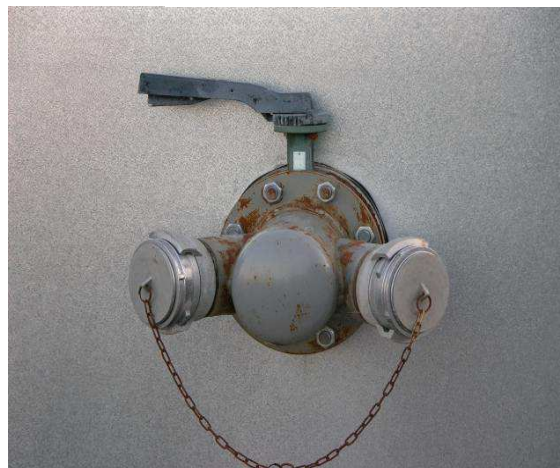
Prises directes de 100 mm sur réserve d'eau incendie
