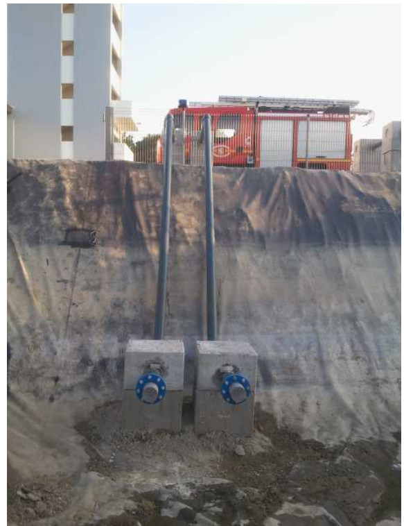
Deux colonnes de 100 mm sur une réserve d'eau ouverte
