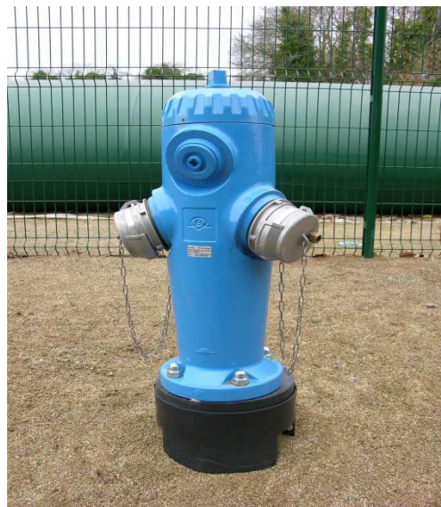
Poteau d'aspiration classique de 150 mm, muni de deux sorties de 100 mm et d'un carré de manœuvre.
