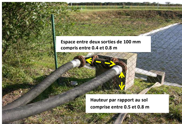
Deux sorties de 100 mm sur une colonne de 150 mm
