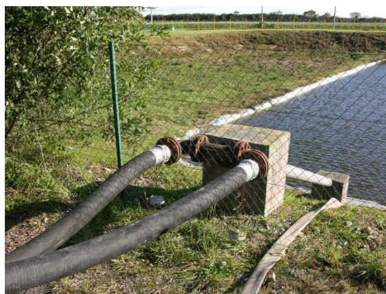
Réserve d’eau ouverte avec 1 colonne de 150 mm alimentant 2 sorties de 100 mm
