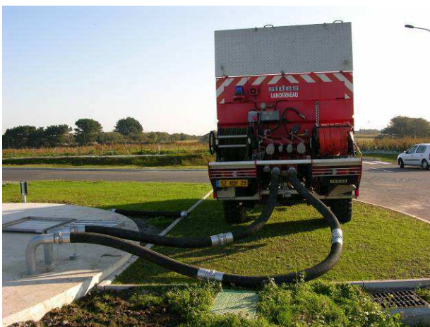
Aire d'aspiration sur une réserve d'eau enterrée équipée de deux colonnes d'aspiration de 100 mm
