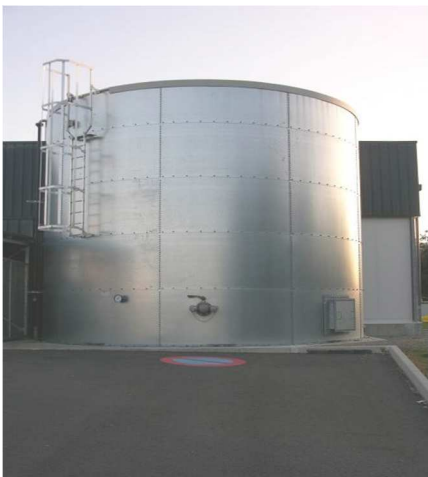
Réserve d'eau incendie aérienne
