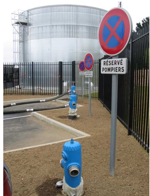
Réserve d'eau incendie aérienne de 720 m 3 équipée de 3 poteaux d'aspiration de 150 mm
