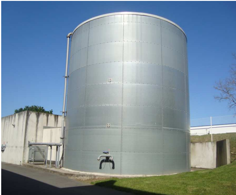
Réserve d'eau incendie aérienne équipée de 2 sorties de 100 mm
