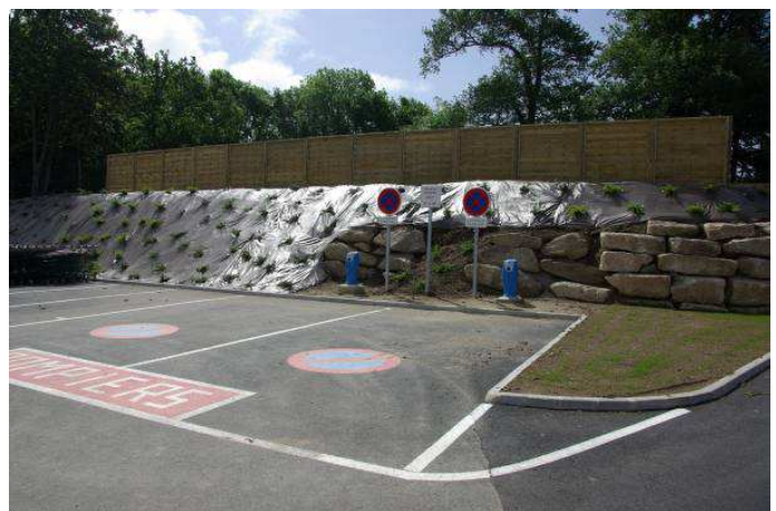
2 aires d'aspiration sur une réserve d'eau équipée de poteaux d'aspiration
